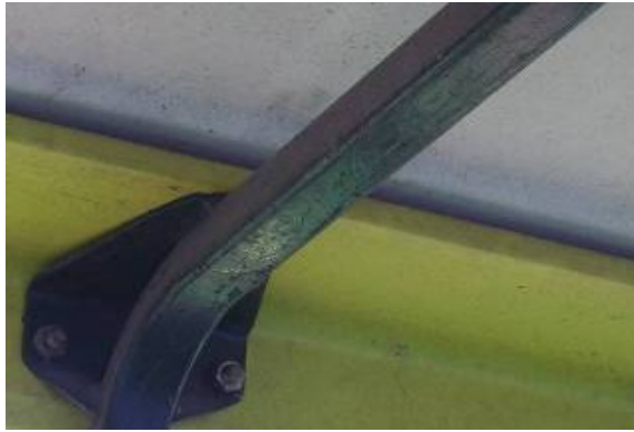
Fig. 1. Esempio di verniciatura degradata, senza segni di corrosione superficiale
