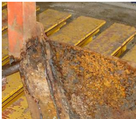
Fig. 3. Esempio di corrosione avanzata, con una riduzione della sezione resistente nettamente superiore al 20%, ovvero corrosione passante (in questo caso, 3 dei 4 lati del tubo quadro visibile nella parte sinistra dell'immagine, in basso, sono completamente assenti)
