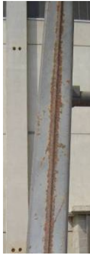
Fig. 4. Classico esempio di cricca generatasi in corrispondenza del cordone di saldatura di un tubolare a sezione quadra
